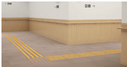
警告(イエロー)・誘導(イエロー)使用
